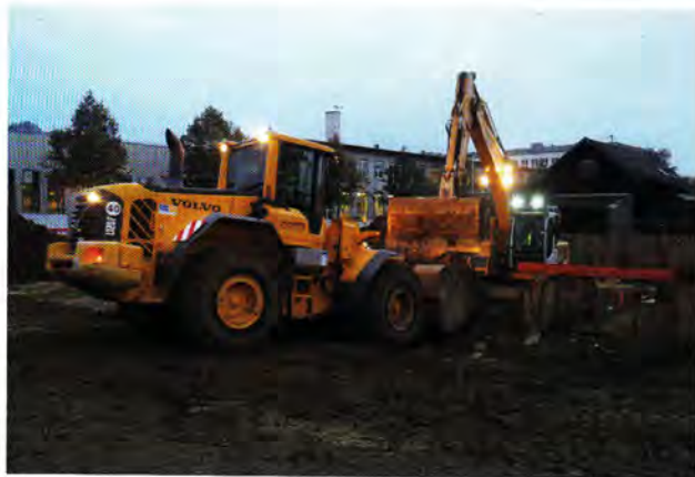
Arbeitsbereiche bei J+B Küpers mit Staubbelastung und kontaminierten Böden.
